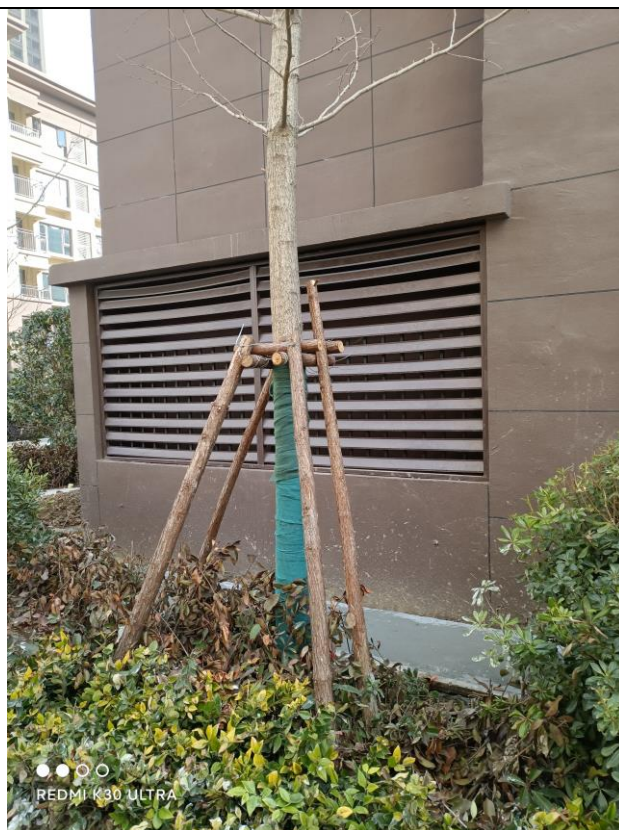
地下室排风井
